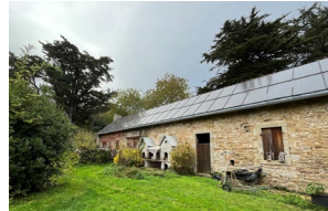
Toiture photovoltaïque, Douarnenez. © Fabien Sénéchal (ANABF)
